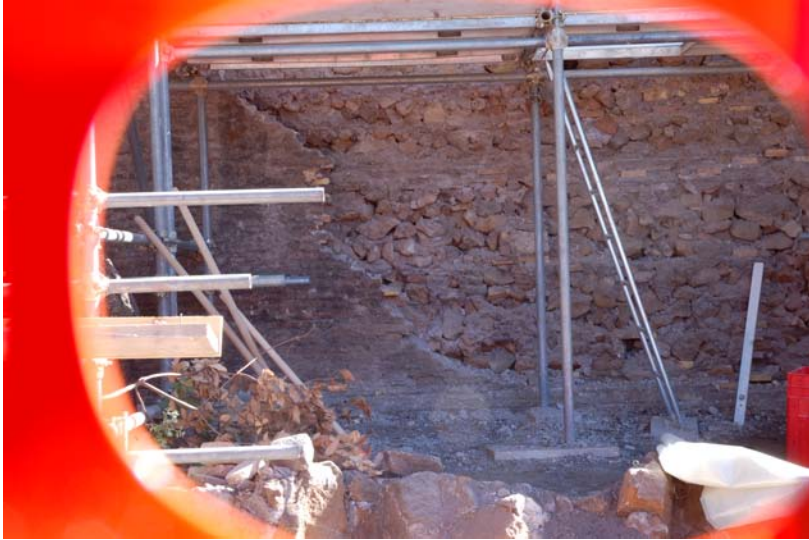
Crollo del Muro Valadier al Pincio
