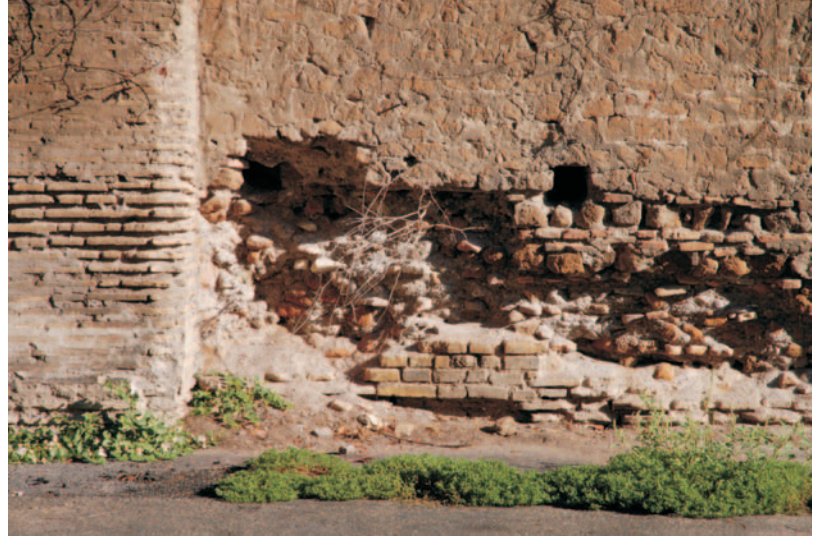
Crollo delle Mura Aureliane in Via Sforzesca
