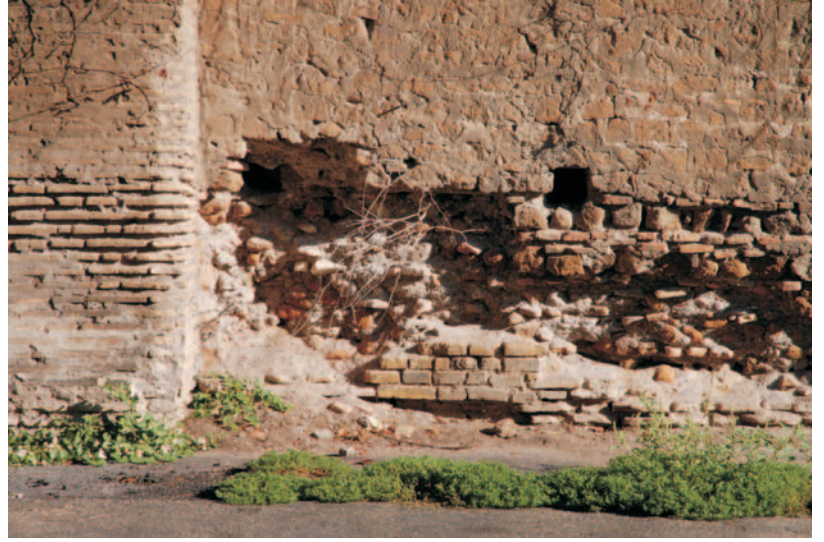
Crollo delle Mura Aureliane in Via Sforzesca
