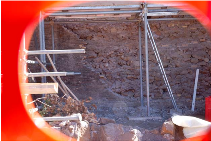
Crollo del Muro Valadier al Pincio
